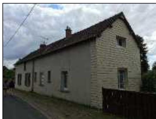
Enduit et bardage inadapté à Saint Julien-de-la-Liègue
