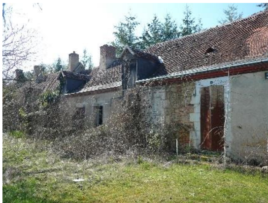
1. Saint-Florentin. Bâtiments vacants en bande. Recommandation : opération de réhabilitation ; aménagement des espaces extérieurs et sécurisation des accès au centre du bourg.
