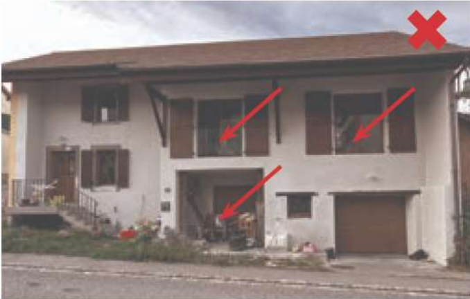
Brens. Percements trop importants et création d'un porche. L'ancienne façade est complètement gommée.
