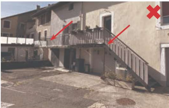
Bons. Escalier avec limon en métal et rambarde bois avec un dessin lourd. On note la différence avec le garde-corps adjacent.
