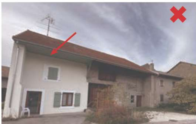
Brens. Forget de toiture formant plafond qui cache l'avant-toit. On note la différence entre la partie droite et gauche.
