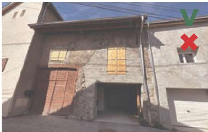
Bons-en-Chablais. Conservation de la porte de grange d'origine mais création d'une nouvelle ouverture non cohérente.
