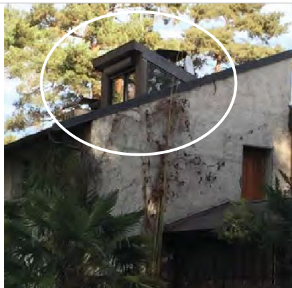
Les joues de lucarnes vitrées sont Interdites
