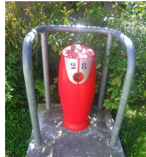
Poteau d'incendie numéroté sur Desingy
