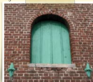
joints blancs sur un bâtiment agricole
