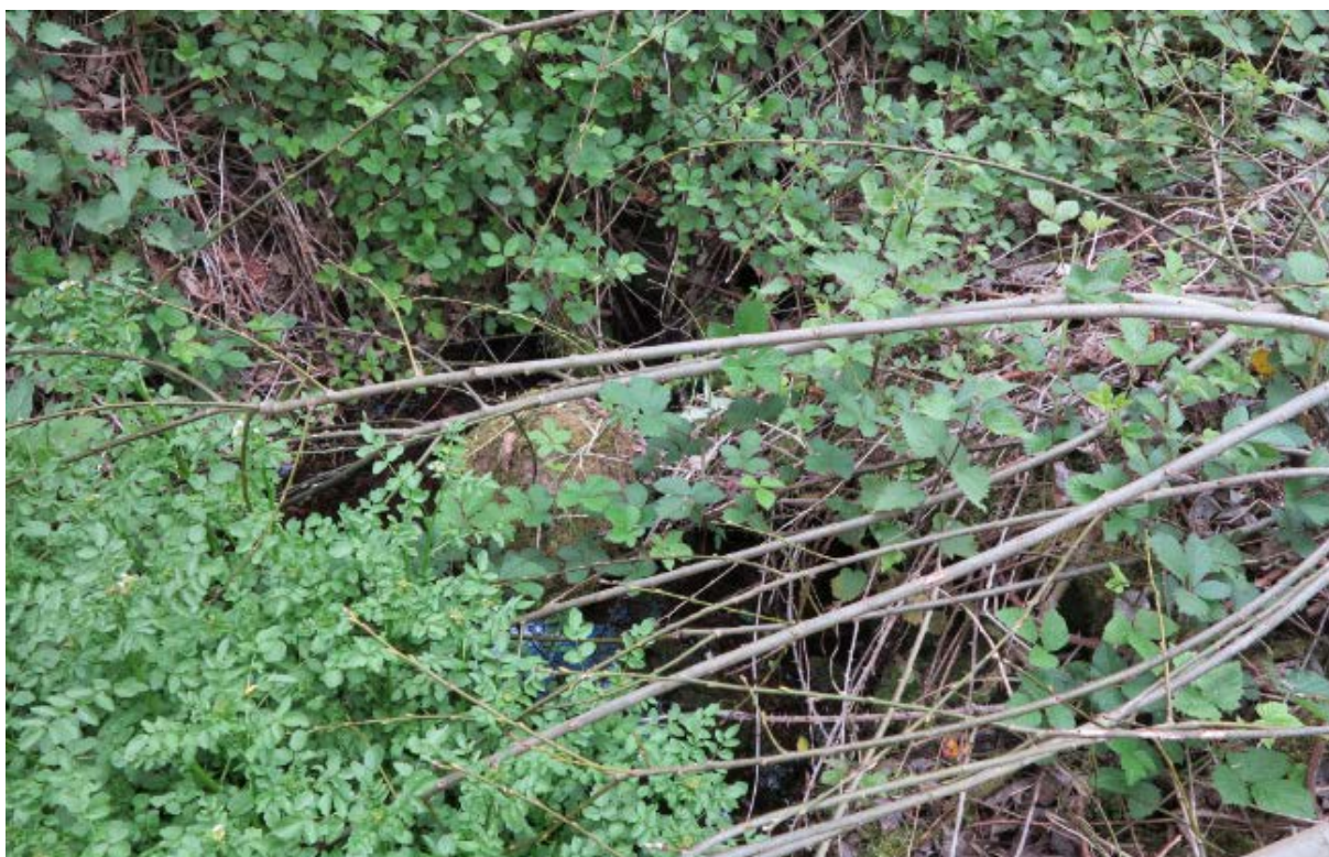
Photo 2 : Résurgence de l'ouvrage hydraulique G1 – cote 650
