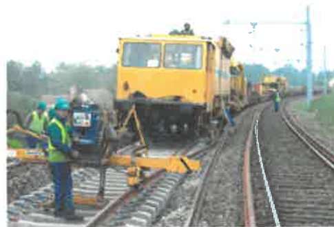
Longs Rails soudés sur traverses béton
