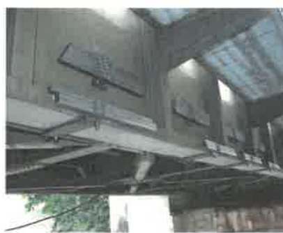
absorbeur sur platelage
