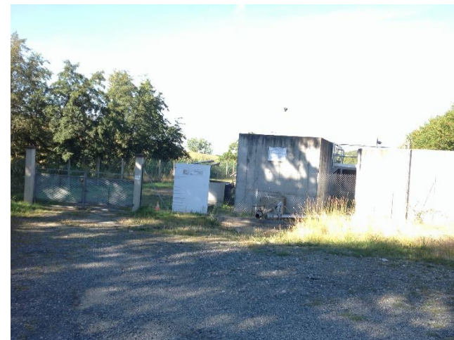
Station d'épuration du bourg
