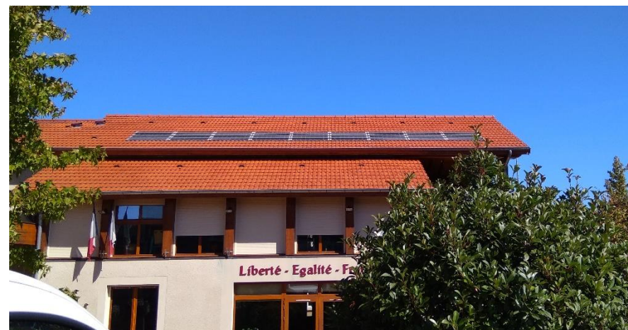
Panneaux photovoltaïques sur la mairie
