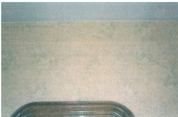
Fissuration intérieure, tapisserie déchirée - Maison André.
