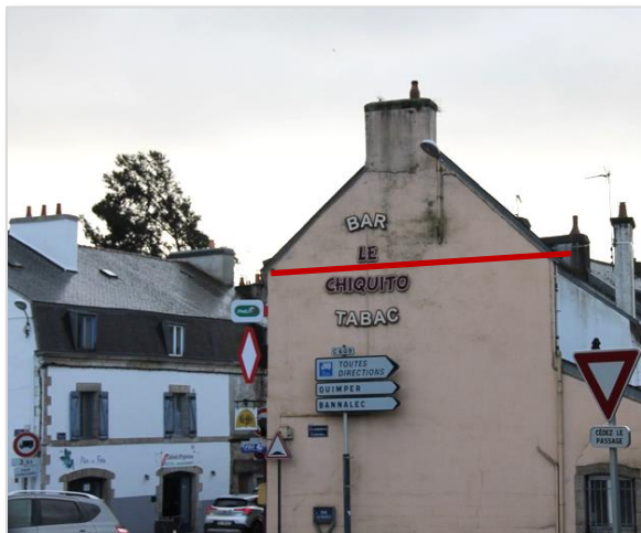
Dépassement de la limite d'égout du toit
