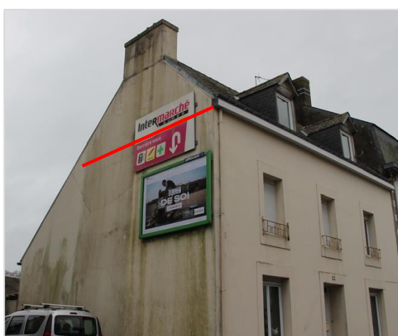
Dépassement de la ligne d'égout du toit
