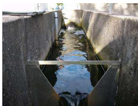
Canal de sortie de la STEP
