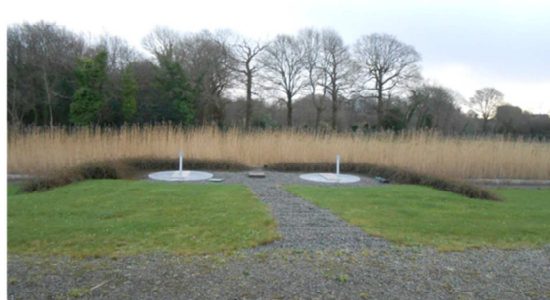
Ouvrage de chasse 2 nd étage et 2 nd étage de filtration
