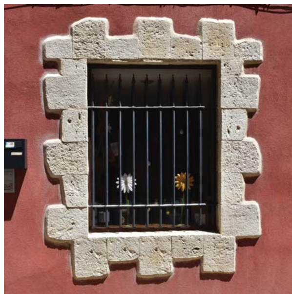
Cadre de baie présentant des harpes* trop saillantes (fonds de façade trop en retrait).
