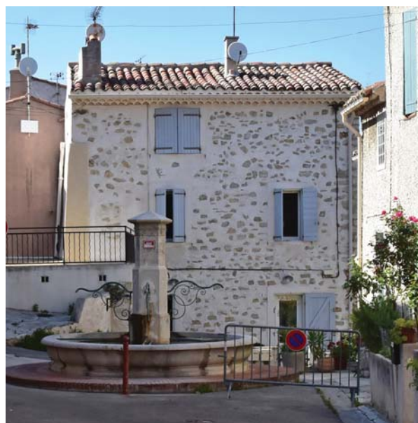
Exemple d'intervention déconseillée : parement à pierres vues avec rejointoiement au mortier de chaux beurré avec excès.
