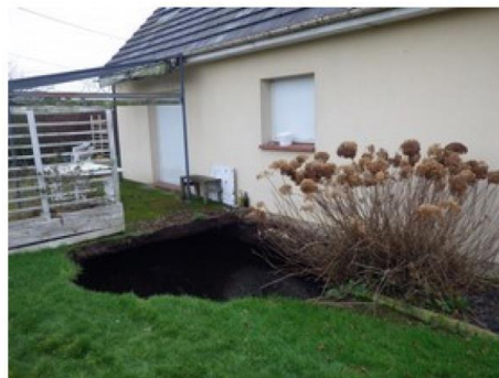
Effondrement d'une marnière, Saint Mards de Fresne. Source : DDTM27
