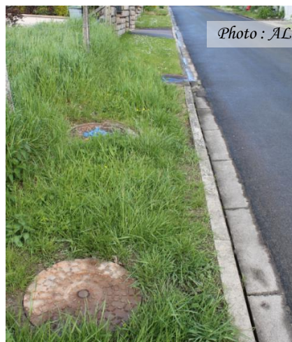
Photo n°10 Deux puisards (Vadencourt)
