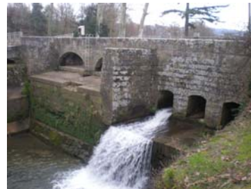
- L'épanchoir des Thoumasés - Cliché : RISQUE & TERRITOIRE.
