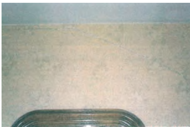
Fissuration intérieure, tapisserie déchirée - Maison André.
