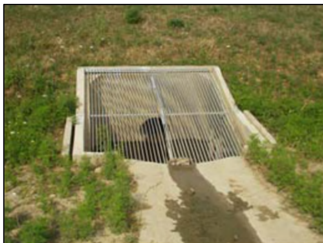
Figure 19 : Grille de protection sur ouvrage de sortie
