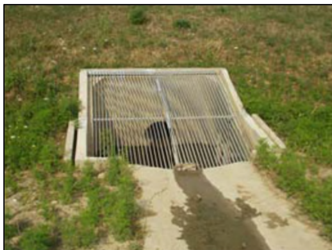
Figure 19 : Grille de protection sur ouvrage de sortie
