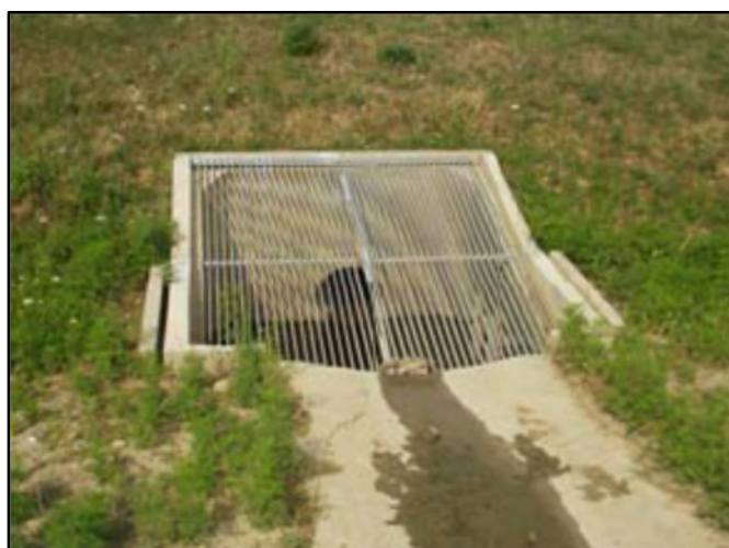
Figure 19 : Grille de protection sur ouvrage de sortie
