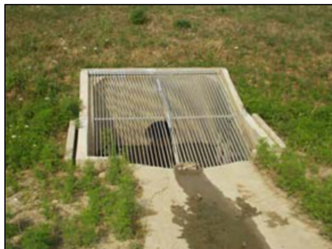
Figure 19 : Grille de protection sur ouvrage de sortie
