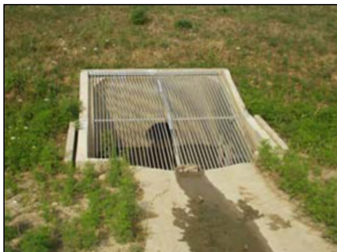
Figure 19 : Grille de protection sur ouvrage de sortie
