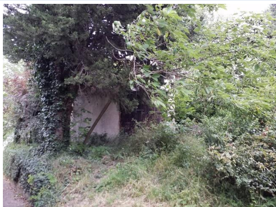
J1.5-Constructions abandonnées des villes et des villages – AUc s8
