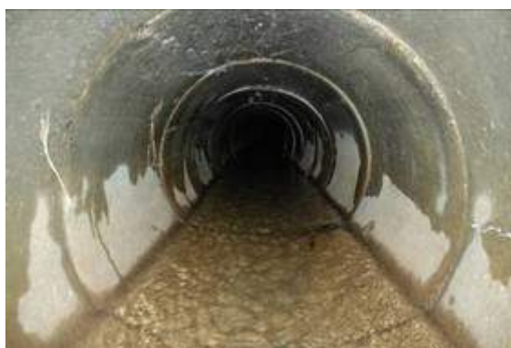
FIG. 21 : Réseau pluvial sous le boulevard Henri LACLAU
