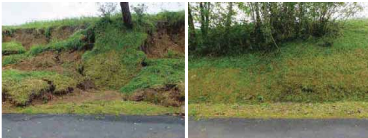
Route au-dessus de l'étang de la Croix Percée : aux endroits où sont présents des arbres ou des haies, les talus ne sont pas effondrés (photos d'un habitant du Livradois Forez)
