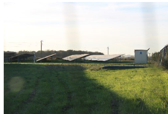
Parc photovoltaïque au sol Source : Artifex-SOCOTEC 2020
