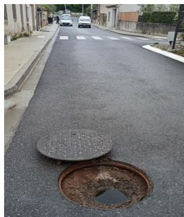
Figure 6 : Puisard situé en bas de la rue Jean Mermoz
