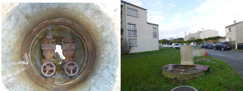
Figure 25 : Équipements corrodés - PR Floralties
