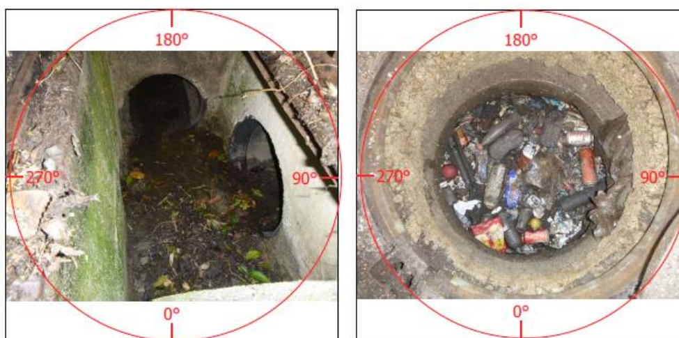
Figure 7 : Exemples de regards obstrués
