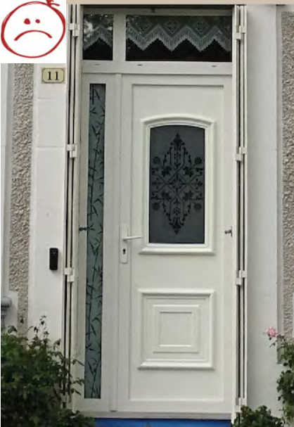
Porte d'entrée inadaptée à l'ancien
