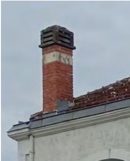
Chapeau de cheminée inadapté
