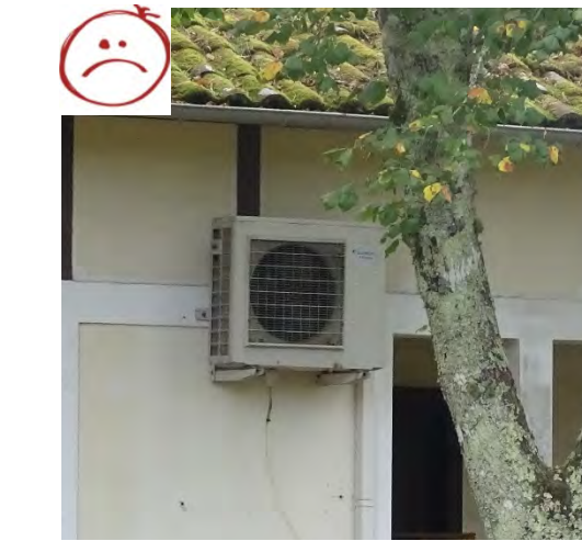
Éviter l'implantation visible depuis la rue de blocs de climatisation en saillie, non intégrés
