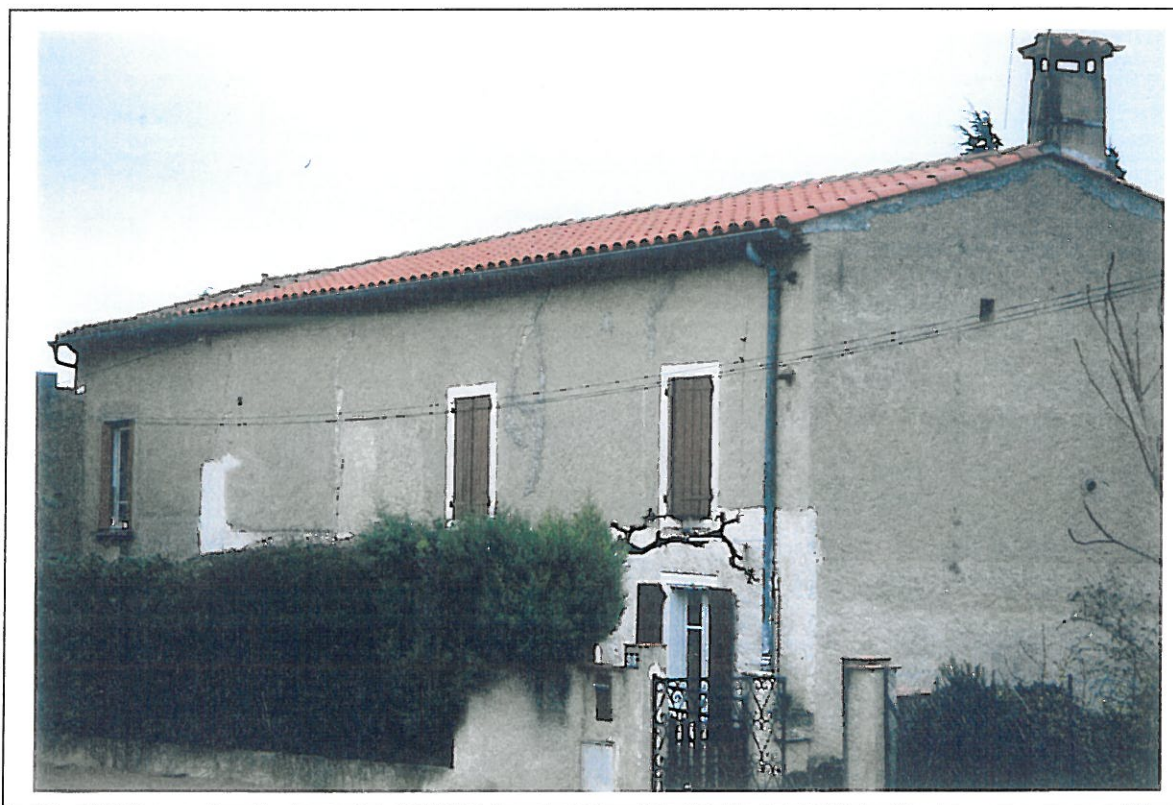
Photo 21 : Lieu-dit Secteur de Lameilhé, 53 rue Goya. Photo prise en mars 1999. Fissures rebouchées dans le bâti sur molasses argileuses. Fondations de moins de 1m.
