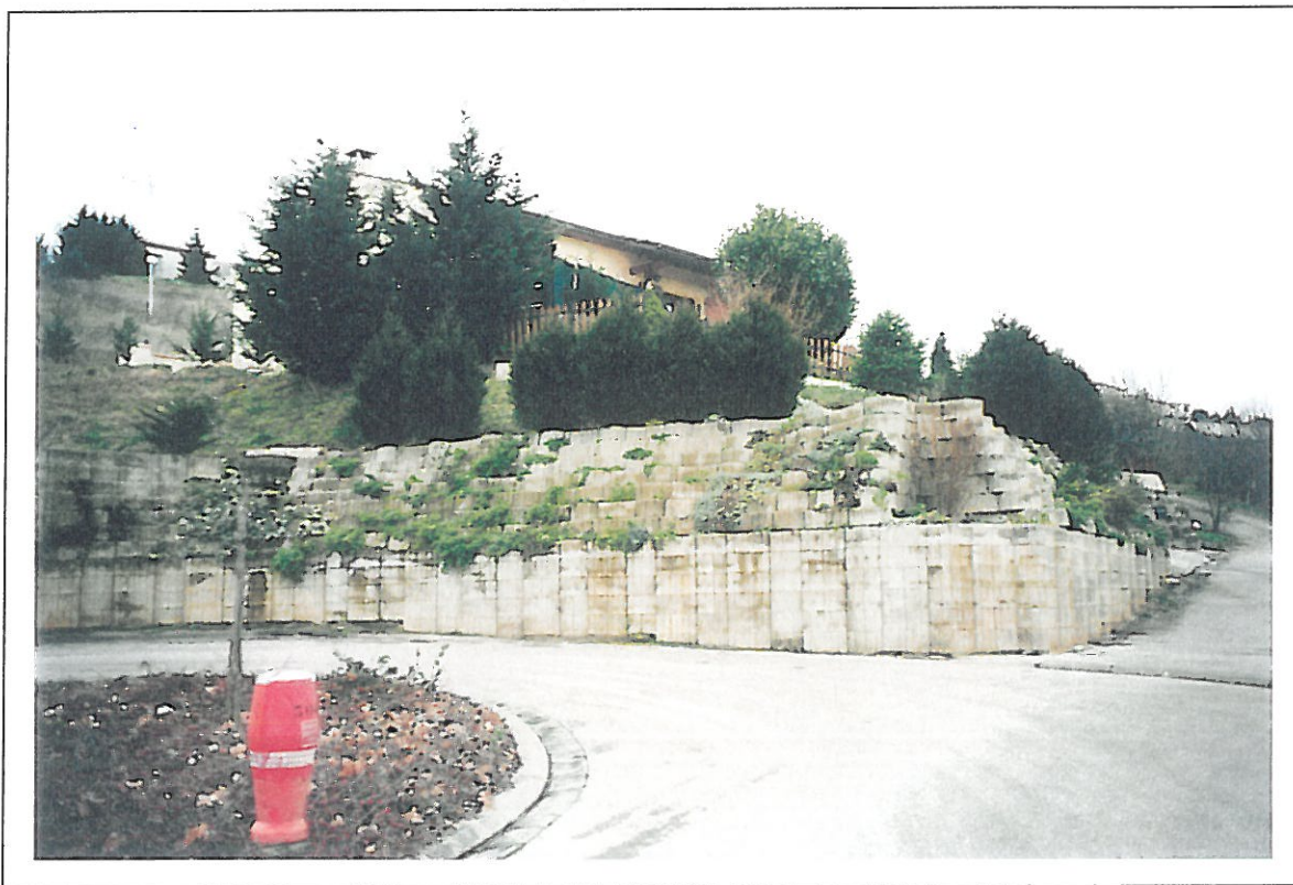
Photo 8 : Lieu-dit Roulandou à l'Ouest de Lardailly. Photo prise le 21 février 2000. Un exemple de protection retenue par un particulier pour éviter la mise en mouvement de son bas de terrain. Ce perré en cellules de béton peu stabiliser le versant, mais les traces d'écoulements sur la structure indique que le sol en arrière doit souvent être saturé. L'efficacité de ce type d'ouvrage est incertain pour résister à une poussée des terres et demande un surveillance régulière.
