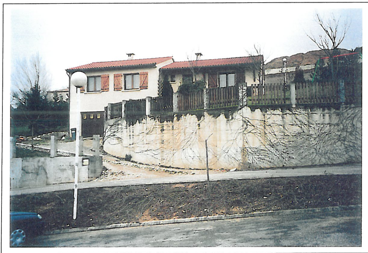
Photo 9 : Lieu-dit Roulandou à l'Ouest de Lardailly. Photo prise le 21 février 2000. Ce type de mur permet de stabiliser le bas de versant, et par-là même l'ensemble de la parcelle. L'ouvrage est bien drainé à la base (buses) mais il est improbable que cela suffise en cas de fort abat d'eau pour éviter la saturation de l'ensemble des terrains. Il est possible que cette structure verticale et fine de ne pourra pas résister à une poussée des terres ; elle doit être surveillée.
