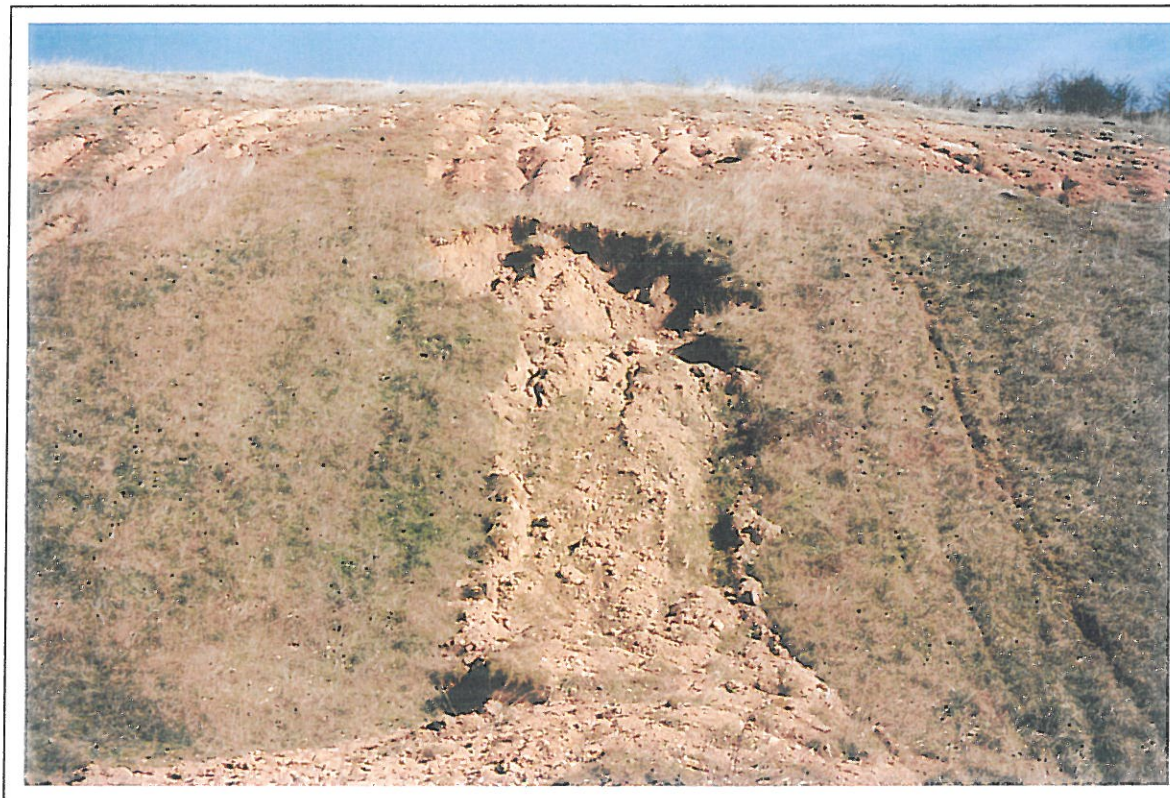
Photo 3 : Lieu-dit Roulandou à l'Ouest de Lardailié. Photo prise le 21 février 2000.
