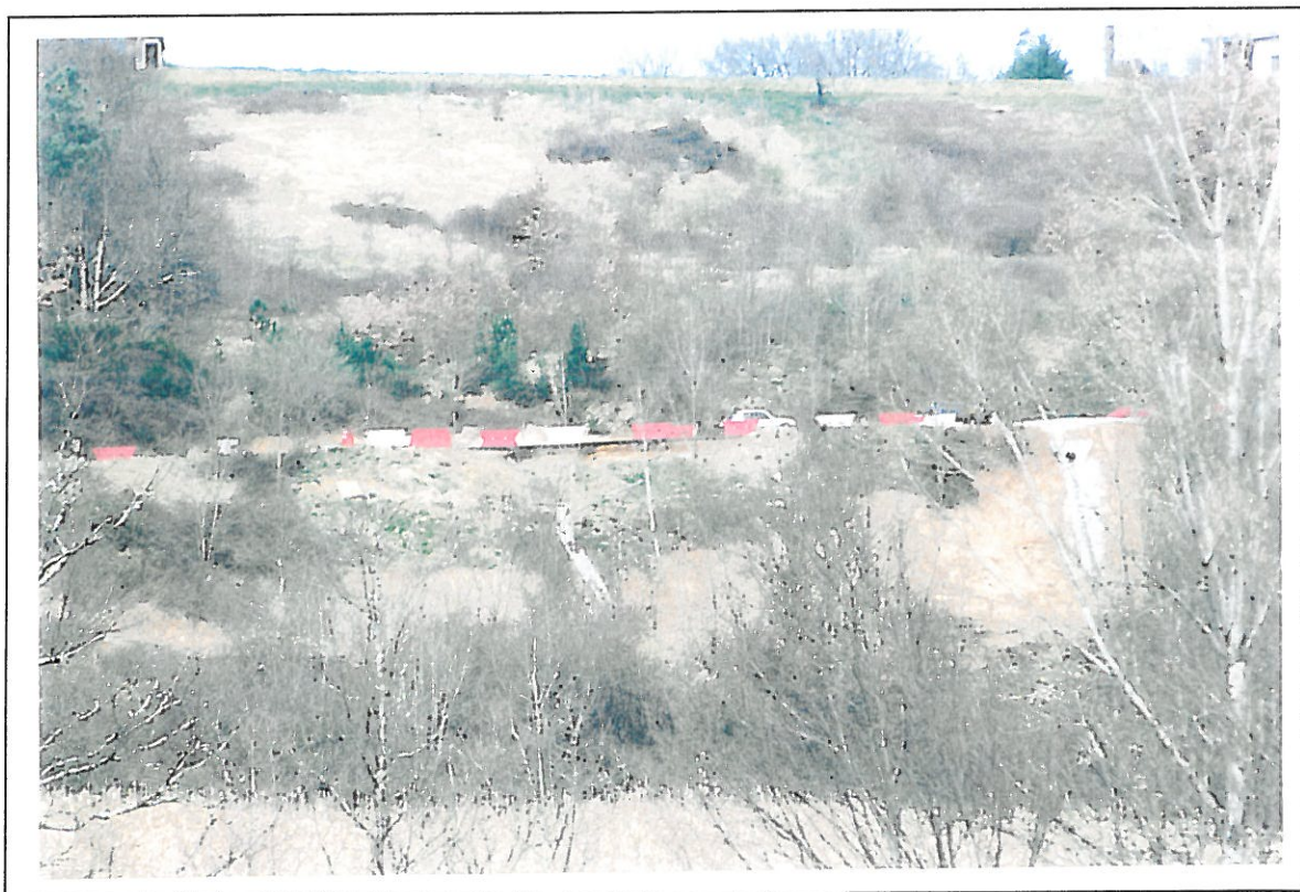
Photo 23 : Route de Brassac (D 622), La Parule. Photo prise en mars 1999. Affaissements et glissements dans les marnes rouges, parées par des travaux de drainage et de soutènement (murs) pour protéger la départementale. Dynamique actuelle.
