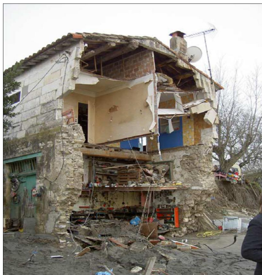
Maison du Garde Digue à Fourques après la rupture, crue du Rhône de décembre 2003
