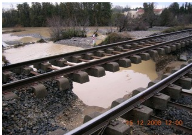
Rupture d'un remblai ferroviaire, crue du Coulon le 15/12/2008
