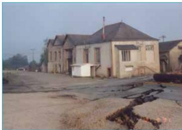
FIGURE 29 : MISE EN PENTE D'UN BATIMENT A LA SUITE D'UN AFFAISSEMENT (49)
