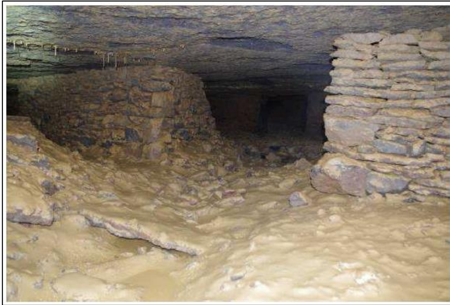
Figure 28 : Aperçu de la zone soumise à un battement de nappe (cliché INERIS - inspection octobre 2016)
