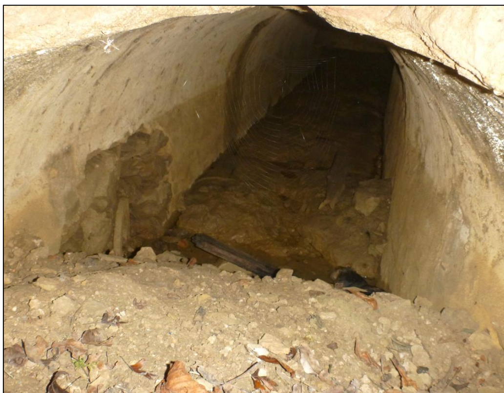
Photo 10 : Galerie technique, puits Saint-Pierre P5
