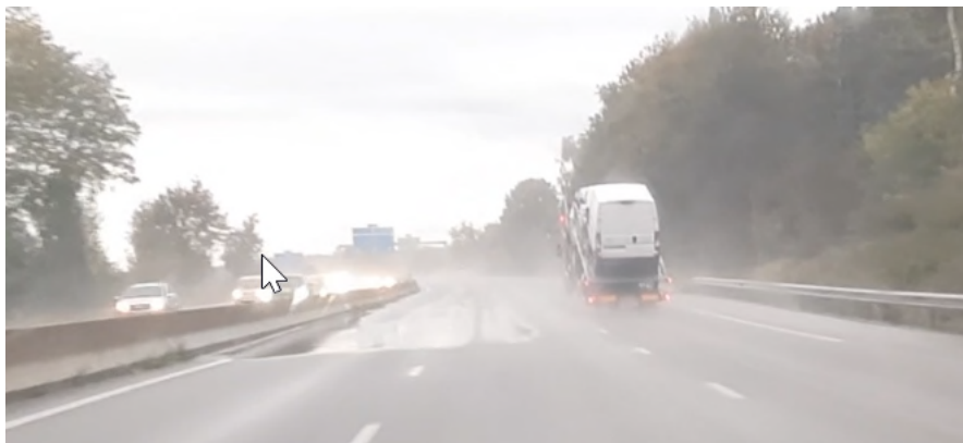
Zone de rétention d'eau sur la chaussée
