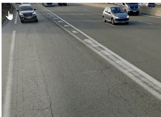
Zone de chaussées dégradées
