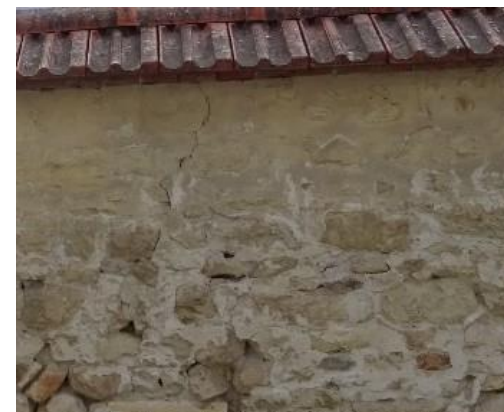
Enduit à pierre vue, dégradé en pied de mur
