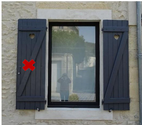
Les écharpes en diagonales sur les volets sont interdites.
