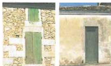
Ces moellons doivent être recouverts d'enduit.
