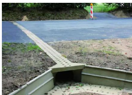
Exemple de passage à faune-crapauduc (Source : Aco)
