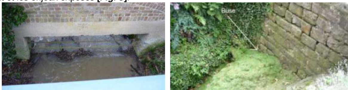
Figure 5 : Exemples d'observations faites sur le terrain pour le risque de débordement (passage trop étroit et grillagé et buse bouchée) [Source : IMS RN ]
