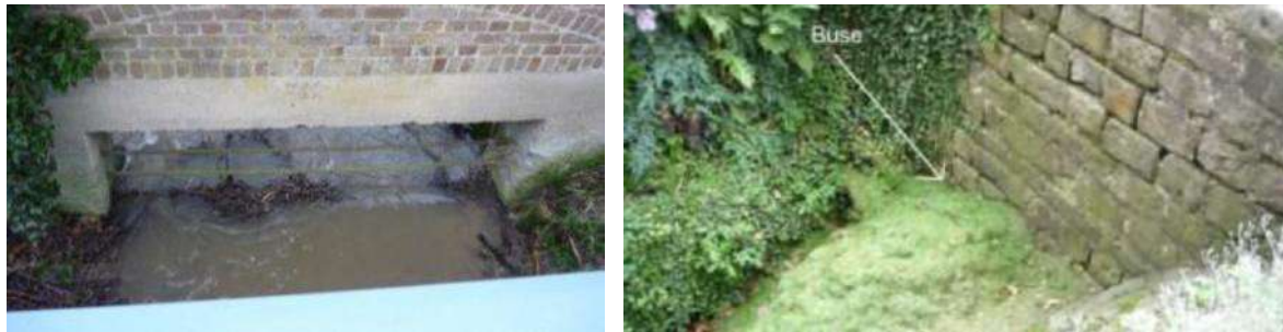
Figure 4 : Exemples d'observations faites sur le terrain pour le risque de débordement (passage trop étroit et grillagé et buse bouchée) [Source : IMS RN ]
