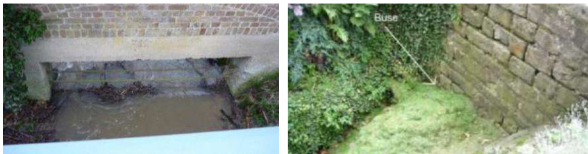
Figure 6 : Exemples d'observations faites sur le terrain pour le risque de débordement (passage trop étroit et grillagé et buse bouchée) [Source : IMS RN ]
