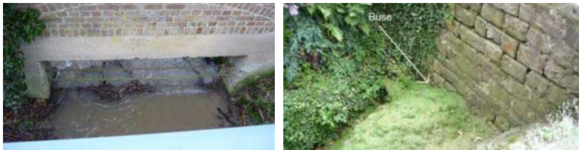
Figure 7 : Exemples d'observations faites sur le terrain pour le risque de débordement (passage trop étroit et grillagé et buse bouchée) [Source : IMS RN ]
