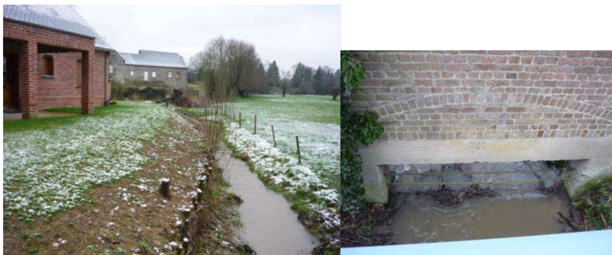
Figure 4 : Nouvelle construction au bord de la Tarsy, à Doulers, avec en aval une buse mal dimensionnée avec des barreaux pouvant être à l'origine d'un embâcle [Source : IMS RN ]
