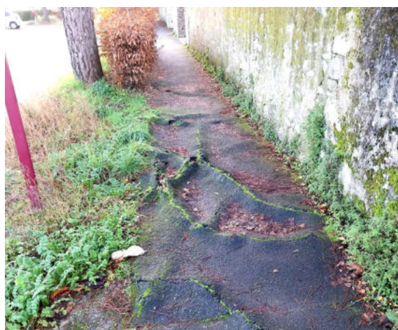
Déformation du cheminement, frein à l'accessibilité
