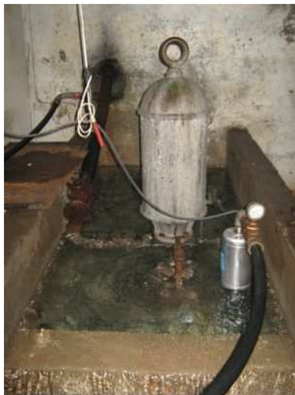
Figure 16 : Vue intérieure de la station de pompage
