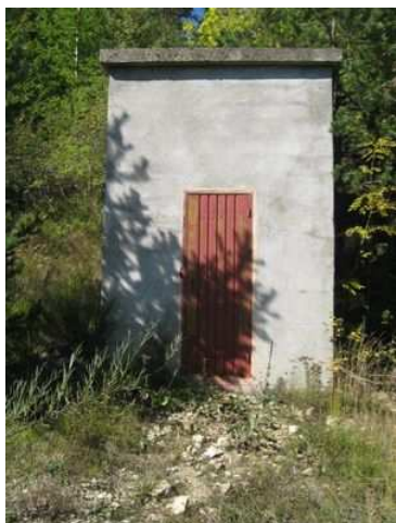
Figure 14 : Réservoir de Chaumie (100m 3 )
