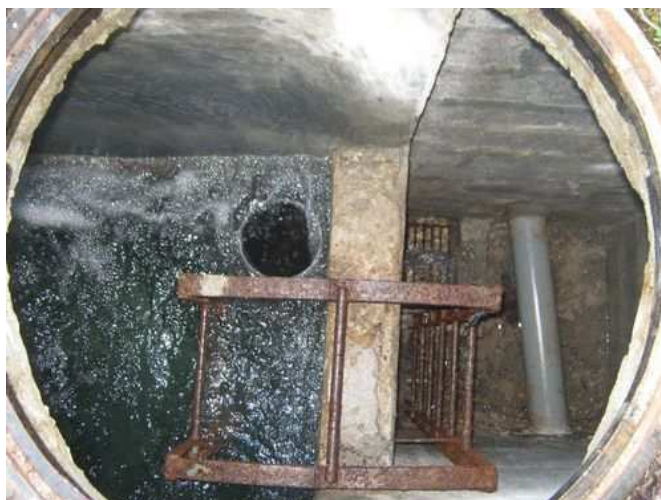
Figure 7 : Source de Chaumaïre
