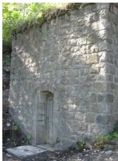
Figure 11 : Réservoir de Geau ( 120\text{m}^3 )
