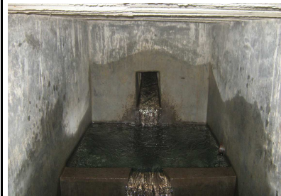
Arrivée du captage dans regard
