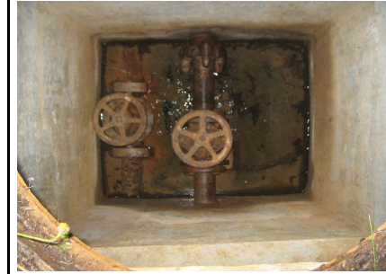
Chambre de vannes dans le regard
