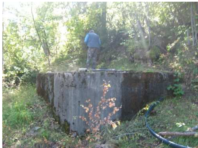
Figure 10 : Réservoir du Haut (8m 3 )
