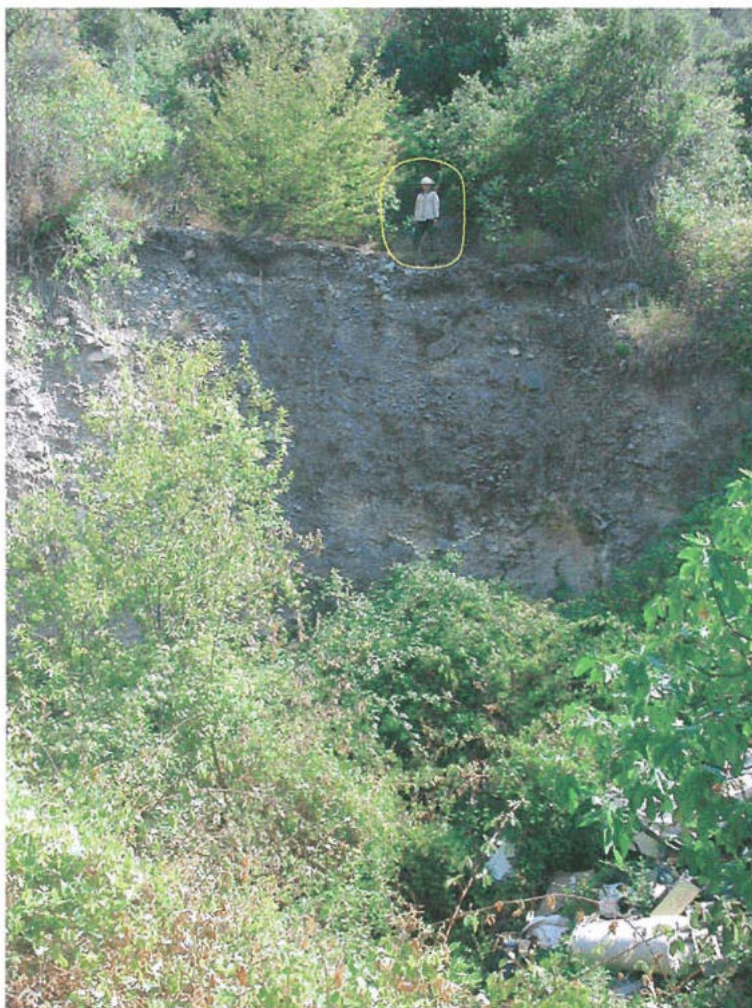
Effondrement au « Collet des Moutons »
