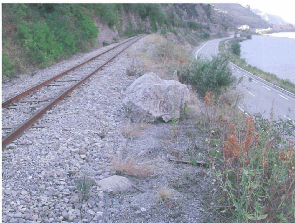
Bloc de volume inférieur à 1 m 3 arrêté au bord de la voie ferrée à proximité du Chaudan.
