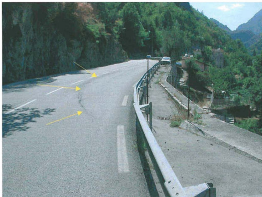
Affaissement de la D2565 à Utelle
