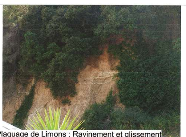
Plaque de limons : Ravinement et glissement
