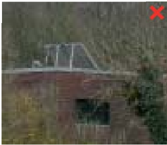
Exemple de panneaux solaires installés de manière partielle ou sur pied. Ce qui dessert l'esthétique du bâtiment.
