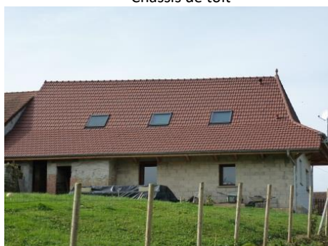
Châssis de toit
