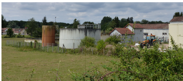
- Station d'épuration à Cosne-d'Allier -
