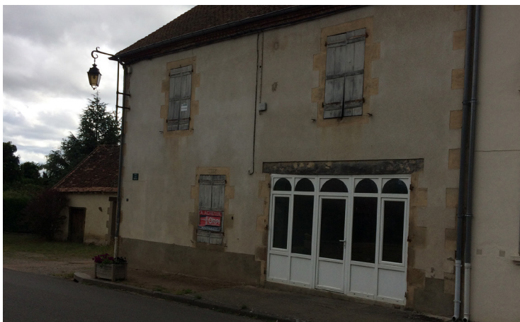
- Rupture dans les matériaux, Venas -
