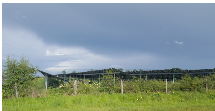
- Panneaux photovoltaïques à Verneix -
