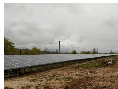
Parc photovoltaïque à Brengues
