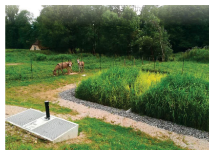
Epuration des eaux usées par un système de filtres plantés de roseaux (St-Pierre-Toirac)
