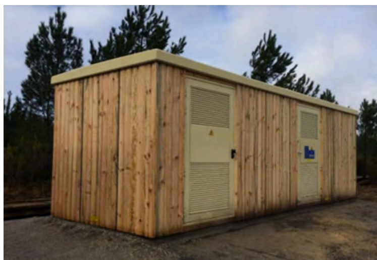
Exemple de poste de livraison bardé de bois (source : BayWa r.e.)
