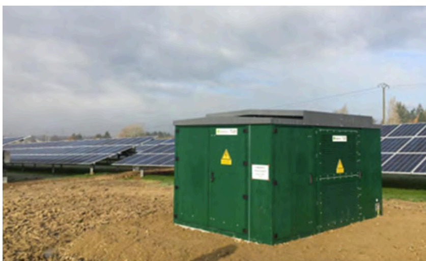
Exemple de poste de transformation (source : BayWa r.e.)
