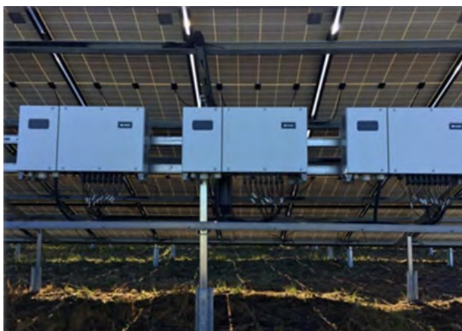
Exemple d'onduleurs « string » (source : BayWa r.e.)
