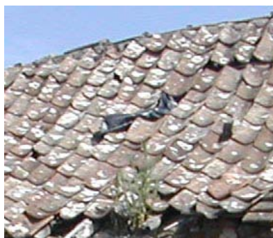
Tuiles dites « baugeoises », sur une construction rurale en mauvais état dans le bourg de Pringé. Elles étaient généralement liées par une emboîture de mortier de chaux aujourd'hui disparue.
