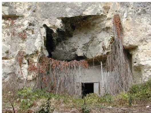
Etat d'abandon des caves
