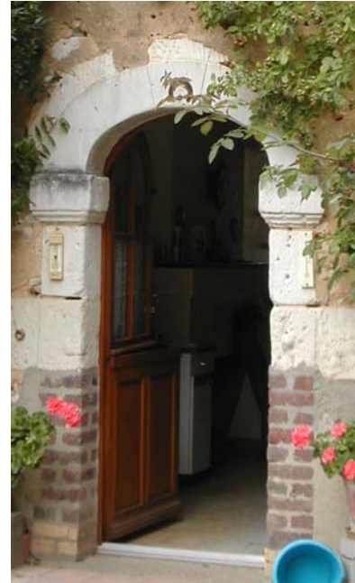
Pierres d'encadrement en tuffeau, remplacées en partie basse par de la brique.
