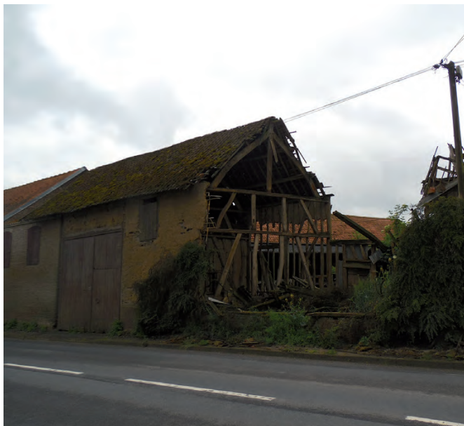
Hedauville - parcelle 5 : architecture de torchis et ossature bois, (en péril si rien est fait)
