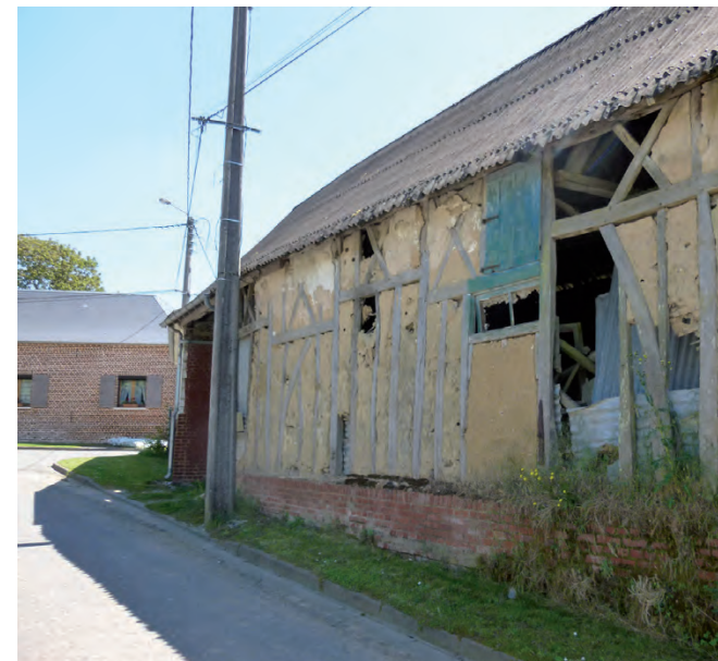
Vauchelles-lès-Authie - parcelles 313 à 315 : architecture fragilisée de torchis et ossature bois
