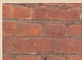
Badigeon de couleur rouge. Il protège les maçonneries de brique de mauvaise qualité. Le badigeon est un mélange de chaux naturelle et de pigments.
