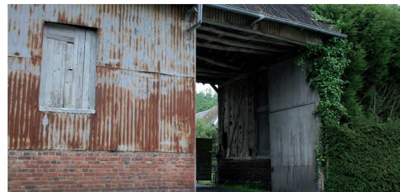
Englebelmer : la réparation de fortune des granges en torchis par du bardage métallique nuit à l'image rurale du village
