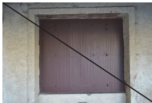
A PROSCRIRE : les volets métalliques.
