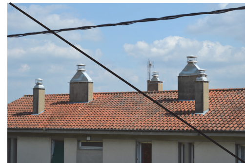
A PROSCRIRE : les couronnements métalliques.
