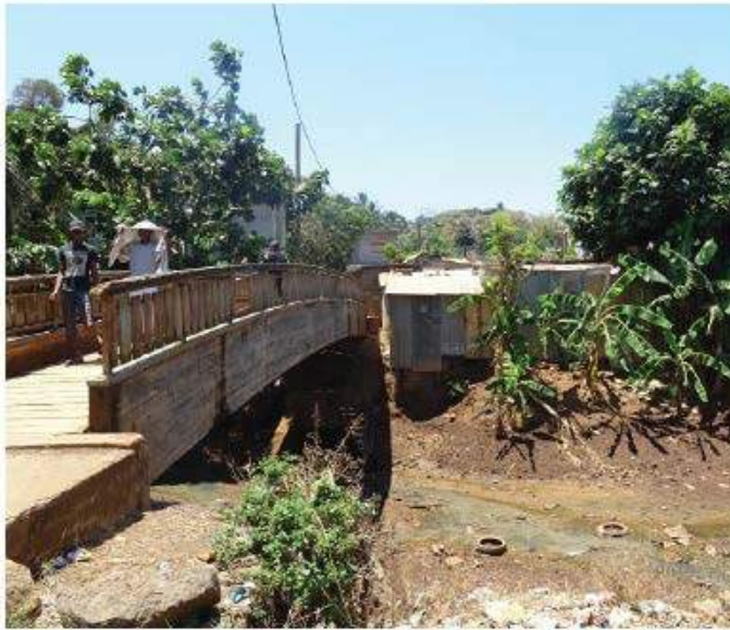
la passerelle piétonne, au droit de Doujani 1. Des rives mises à nues
