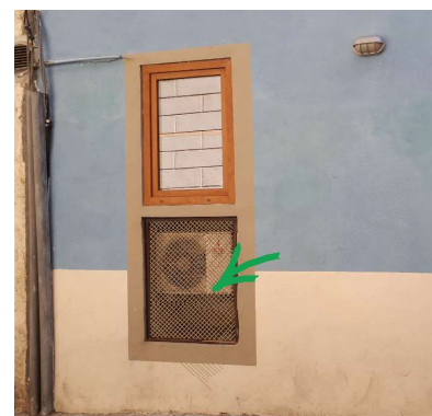
Dans une niche, l'appareil de climatisation doit être masqué par une grille ou des ventelles
