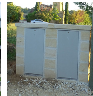
Intégration des coffrets techniques (Monplaisant)
