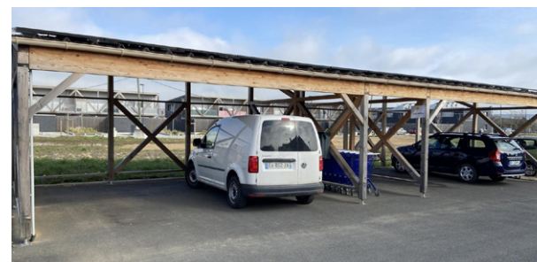
Stationnements ombragés (Blois, 41 - source : http://www.prixnational-boisconstruction.org )
