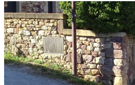
Bonne intégration des coffrets techniques (Grives)...
