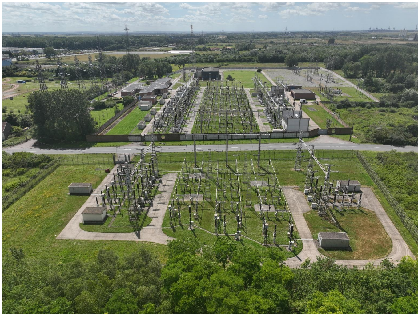
Figure 12 : Photo d'un poste électrique en technologie aérienne de Grande Synthe aménagé en zéro-phyto (59) (Source : RTE)
